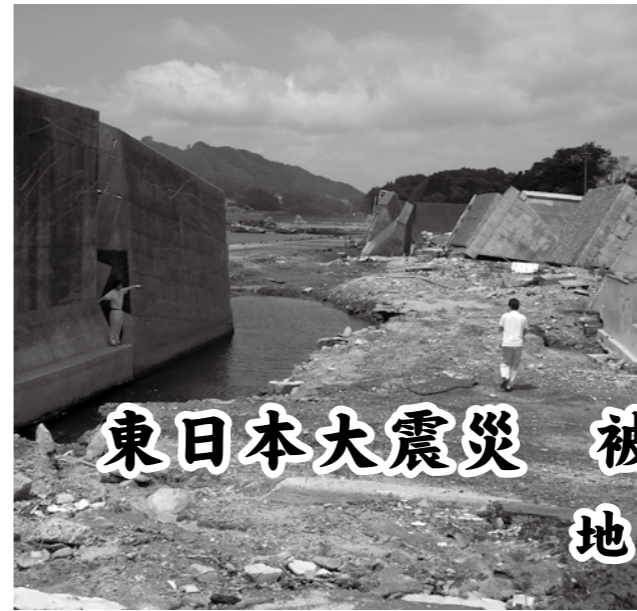
▲防波堤が決壊されている状況 (岩手県山田町)
