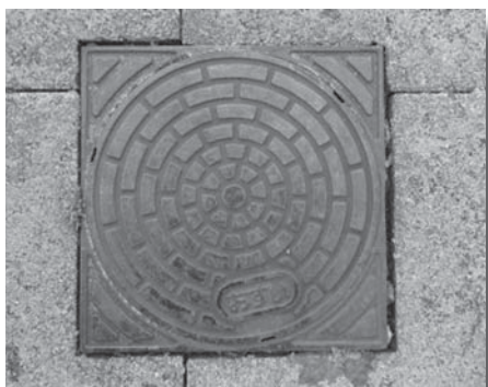
▲汚水まます例(金属製)
