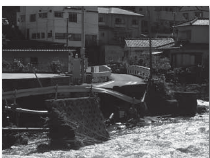
▲令和元年東日本台風で被害を受けた町道
