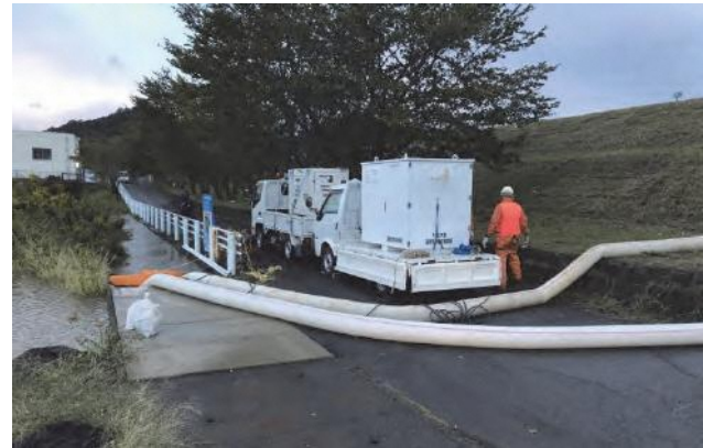
ポンプパッケージの活用
