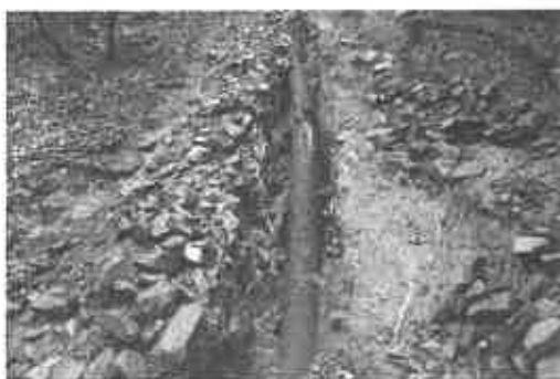
露出した埋設管の様子
