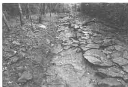
石材流出状況
