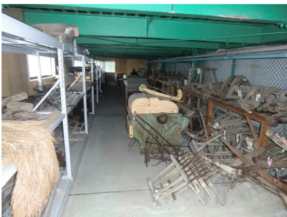
埃と雨漏りの影響で劣化が進んでいる。
