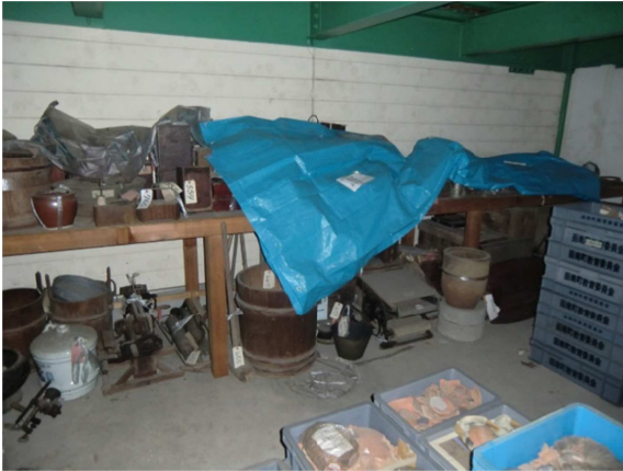
古民具保管状況 (雨漏りのためシートにて養生)
