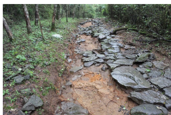
石材流出状況
