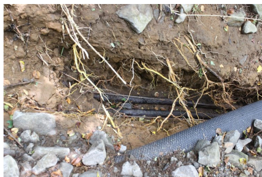
排水管（手前）と地下ケーブル（奥）
