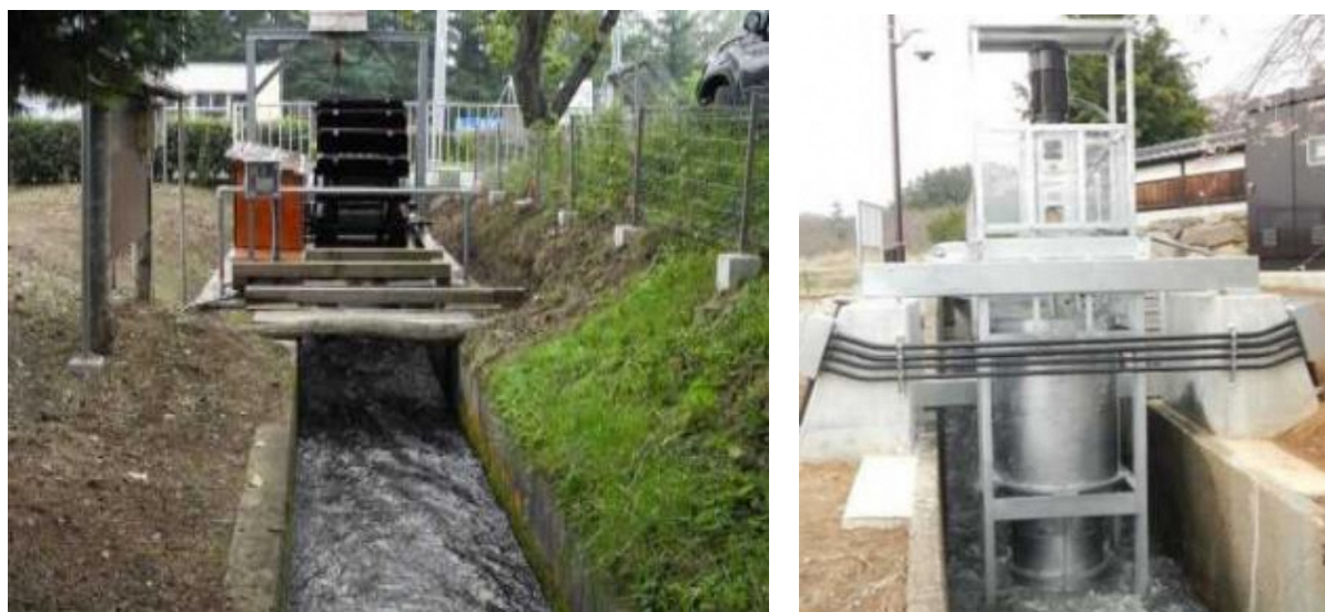
図 4-6 用水路への水力発電設備導入事例
